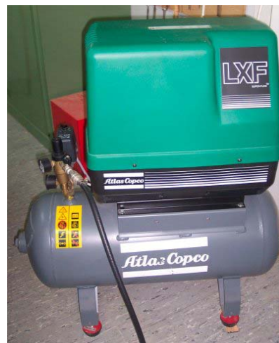
Compresor con su depósito
